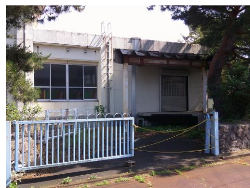
配膳室搬入口（手前の門は開閉不能）
