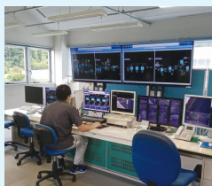
▲浄水場の監視室
