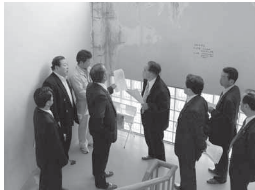
壁のひび割れからの損傷箇所
