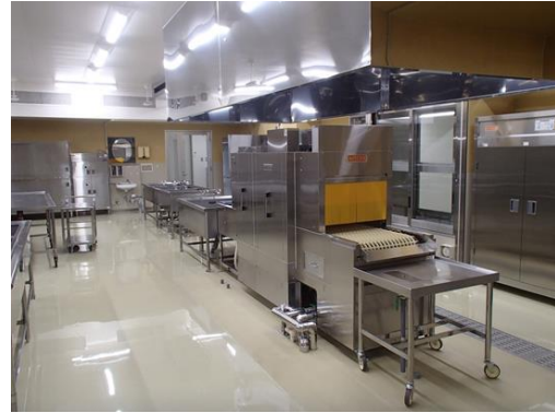
調理室 (水原小学校大規模工事)
