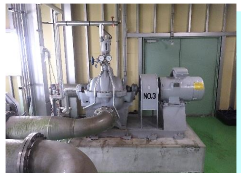
【大室取水場取水ポンプ】
