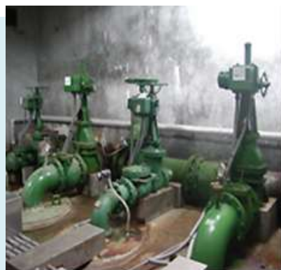
【大室浄水場送水ポンプ】
