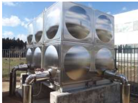
【中山ポンプ場貯水槽】
