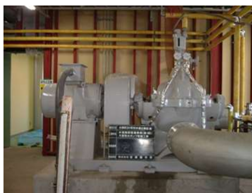
【大室取水場取水ポンプ】
