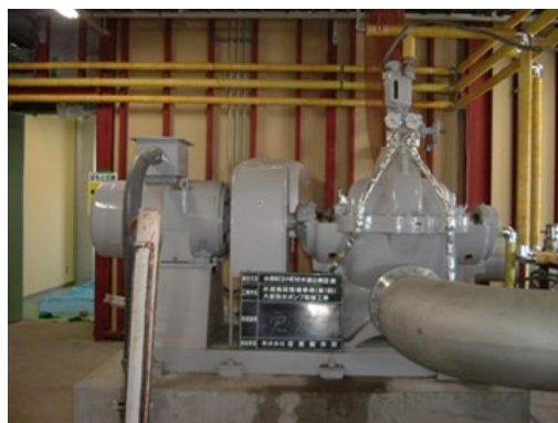
【大室取水場取水ポンプ】
