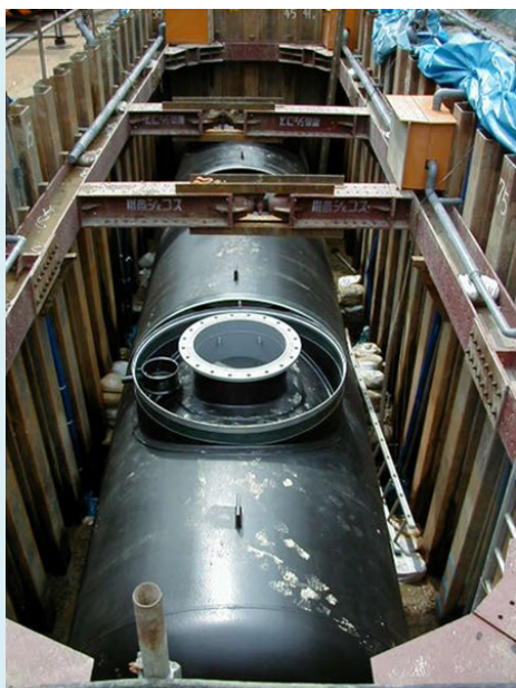
【飲料水兼用耐震性貯水槽（60 m³）】
