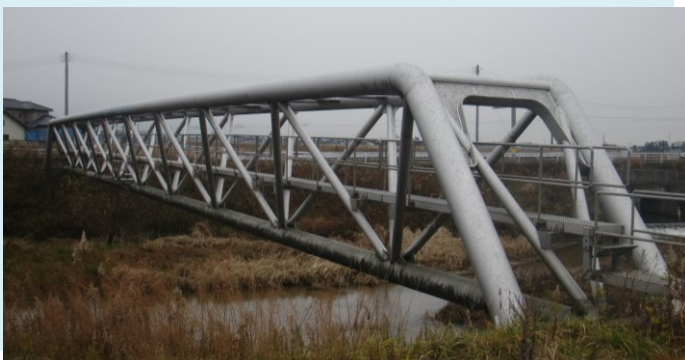
【国道 460 号 折居川φ350 SUS 水管橋】
