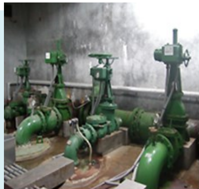
【大室浄水場送水ポンプ】
