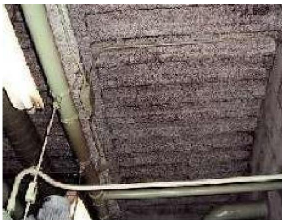
石綿含有吹付ロックウール
