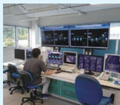
▲浄水場の監視室
