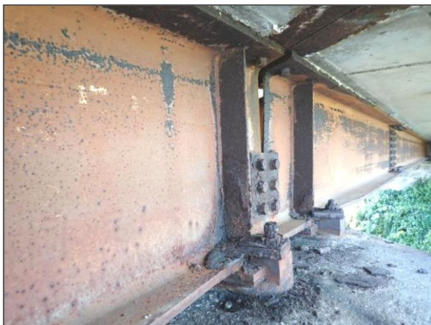
鋼桁の腐食等
