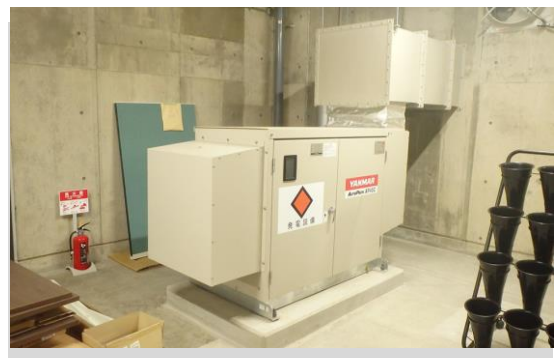
自家発電施設 （道の駅「猪苗代」）
