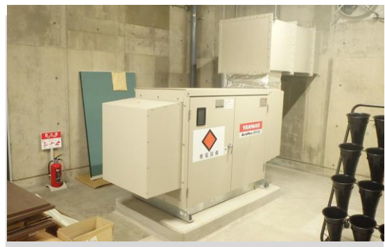
自家発電施設 (道の駅「猪苗代」)
