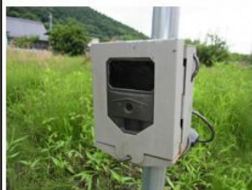
防犯カメラの設置
