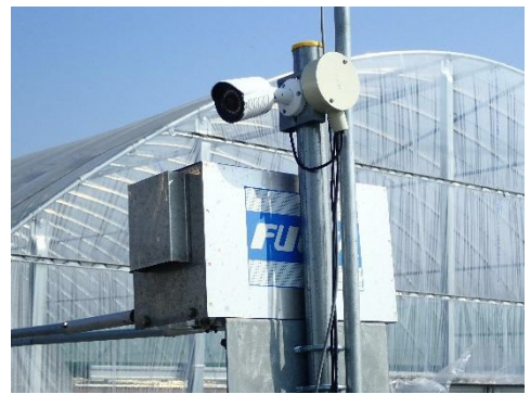
防犯カメラの設置
