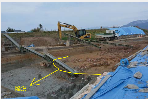
第8図 大規模な陥没①
