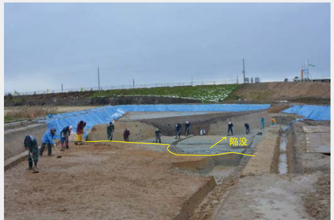
第4図 大規模な陥没のようす
