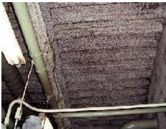
石綿含有吹付ロックウール
