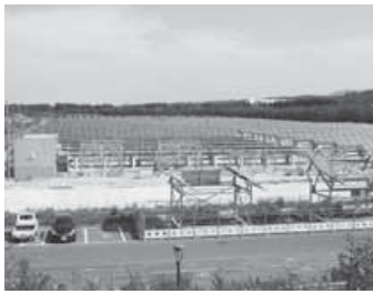
東部太陽光発電所施設 (新潟県東部産業団地内)
